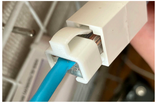
図 7: 修復した LAN ケーブル
